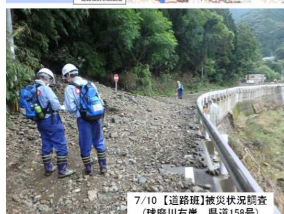
7/10 【遠路班】被災状況調査(球磨川右岸 県道158号)
