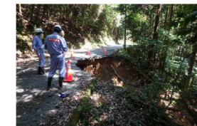
7/30 【道路班】被災状況調査(芦北町)
