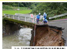
7/9 【遠路班】被災状況調査(熊本県芦北町)
