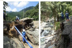
7/30 【道路班】被災状況調査(八代市)
