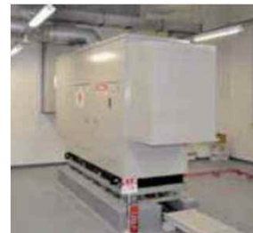
非常用発電設備のイメージ
