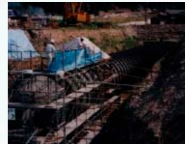
第1集熱水槽（鋼製）
