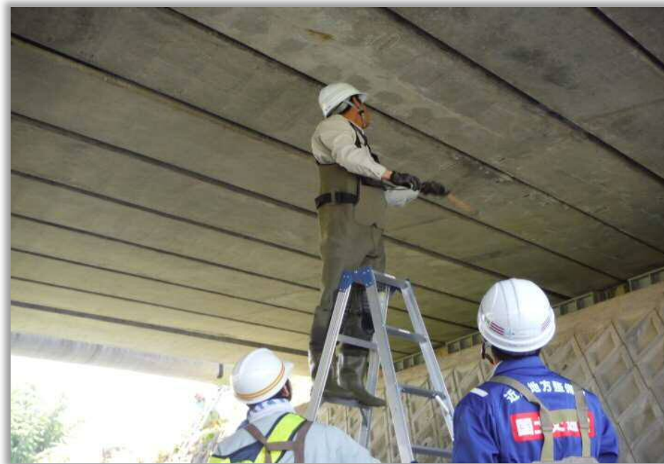
写真：現地調査・損傷状況把握
