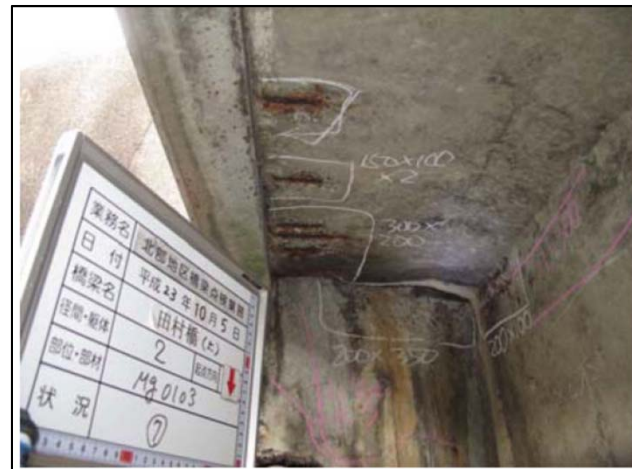
剥離・鉄筋露出
