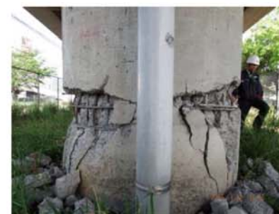
写真-7 段落し部の損傷
