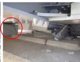
写真-6 支承の破損の状況
