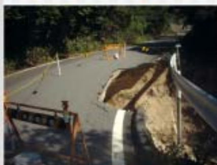
台風による被害状況 国道421号 石樽峠（平成16年10月）
