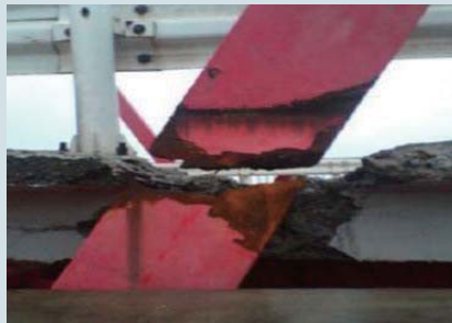
(トラス橋の斜材の破断)【木曾川大橋】
