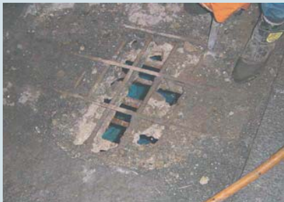
(橋の床版が損傷し抜け落ちた状況)
