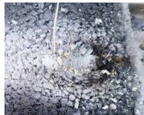
写真2 燃焼後の状況
