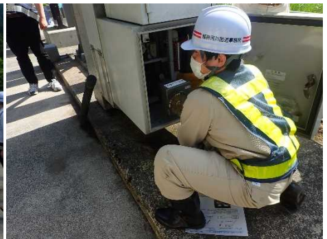
▲遮断機の操作説明の様子（手動操作）
