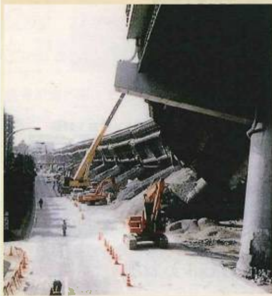
倒壊した阪神高速道路
