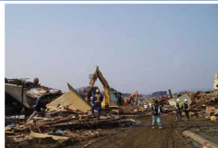
道路脇への山積による車線確保
