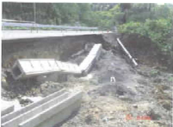
写真 盛土法面の崩壊状況 (東日本大震災での被災事例)
