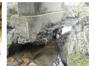
橋脚洗掘：橋脚周辺の土砂が流水により洗い流され消失した状況
