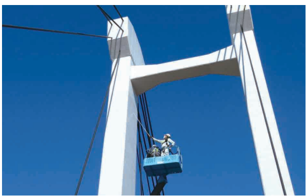
一本杉橋(斜張橋)の主塔部の高所作業車を用いた近接目視点検の状況。特殊構造の橋梁も管理しているため、橋梁の特性を踏まえた点検ができるよう事前の意見交換が重要であった。
