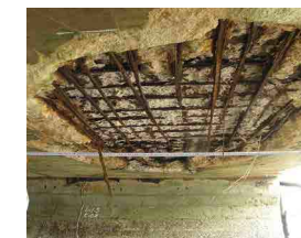
床版鉄筋露出：橋を通行する自動車などの荷重を直接支持し主桁に伝達する部材の鉄筋が露出している状況
