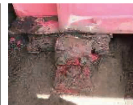
支承腐食：上部構造と下部構造の接続部が腐食している状況
