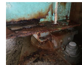
主桁腐食：上部構造から垂直方向に働く荷重を下部構造に伝える桁が腐食している状況
