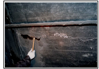
コンクリートの剥離
