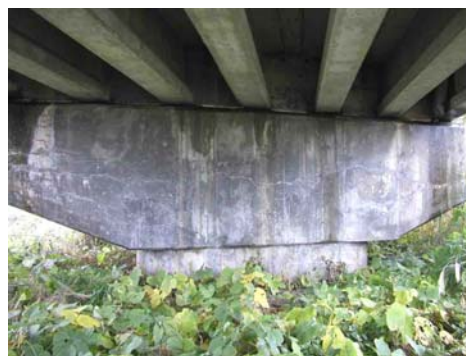
図一解 2.1.2 網目状のひび割れ
