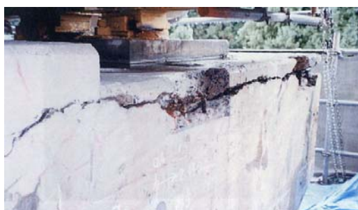
図一解 4.2.1 鉄筋とコンクリートの付着および定着が疑われる鉄筋に沿ったひび割れ
