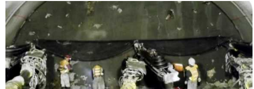
写真 14. 肌落ち防護ネット
