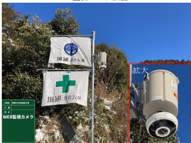
WEB監視カメラ設置
