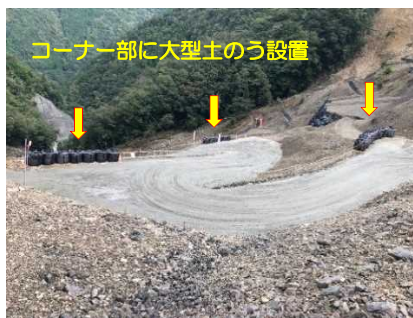
写真 5. 転落防止設備
