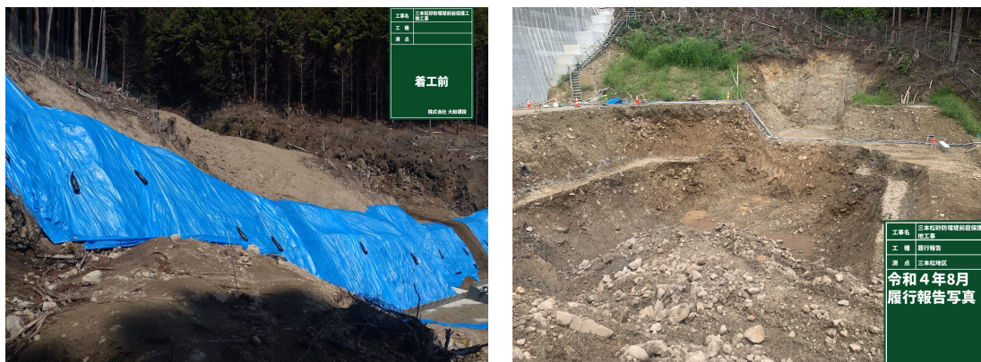
写真2.崩落危険箇所
