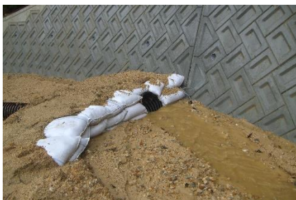
写真-8 素掘側溝土砂埋没状況
