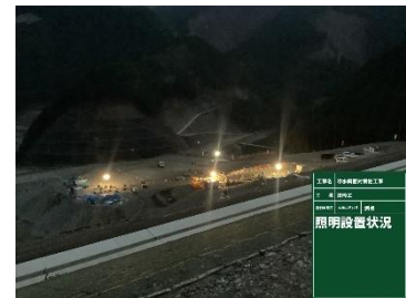
写真-8 照明設備
