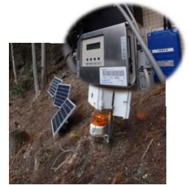
図-17 ソーラーパネル及び 警報装置
