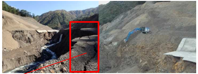
図-4 土砂崩壊・クラック発生状況 並びに 無人化施工状況
