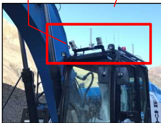
図-6 車載カメラ設置状況
