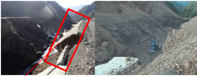
図-3 構築物破損崩壊状況 並びに 無人化施工状況
