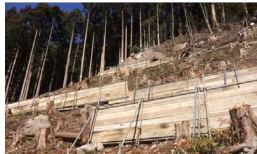
写真-9 多段式木製防護柵
