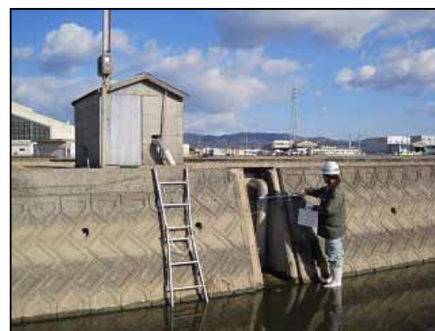
ポンプ取水箇所
