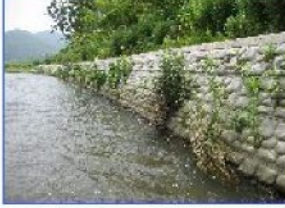
植生の回復した護岸ブロック
