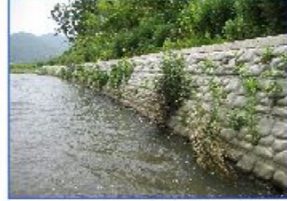
植生の回復した護岸ブロック
