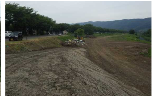
不法耕作の撤去 （平成30年5月撮影）
