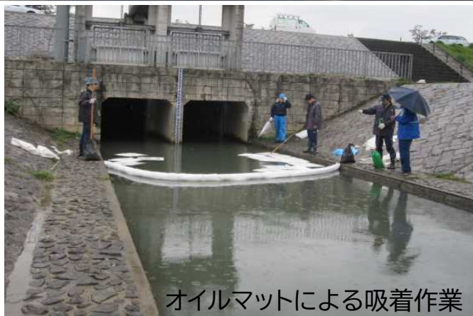
吸着式オイルフェンスの設置例
