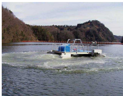
写真 4.2.5-3 循環曝気設備稼働状況
