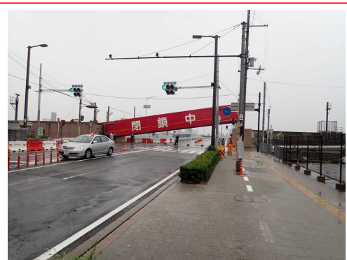
写真 3.3.2-2 淀川陸閘ゲート (平成30年9月)
