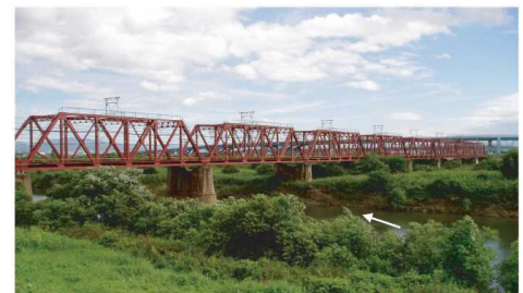
写真 3.6-2 河道内樹木の繁茂状況(木津川)
