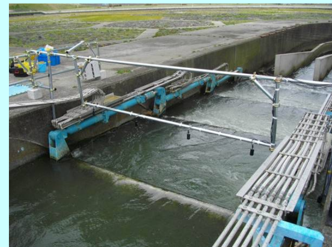
カメラによるモニタリング状況
