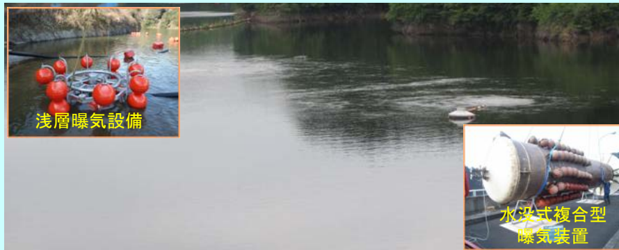
布目ダム 曝気増設状況
