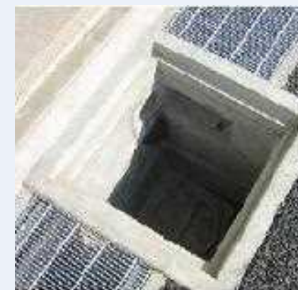
設置している雨水浸透ます
