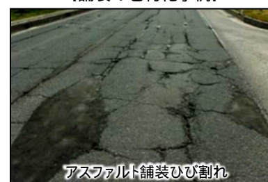
【舗装の老朽化事例】
