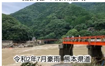
【渡河部の橋梁流失】
