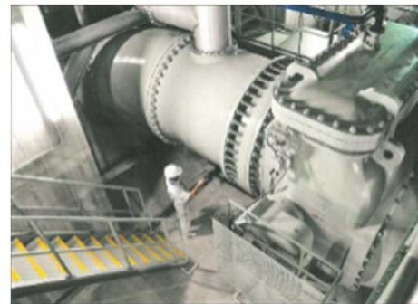
雨水ポンプの整備
