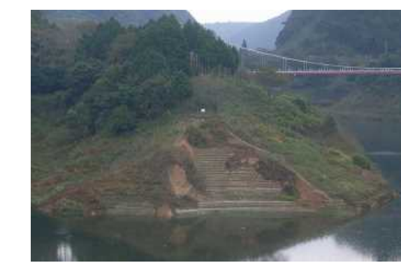
法面浸食があり土留工の施工直後 (平成21年度)
