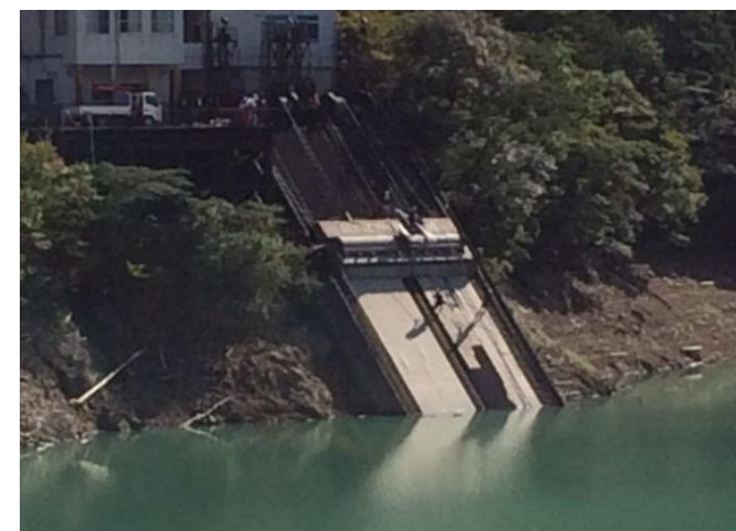
写真-1 表面取水設備損傷状況
