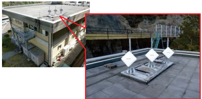
衛星電話のアンテナ設置状況 (北山川電力所ダム制御所)
