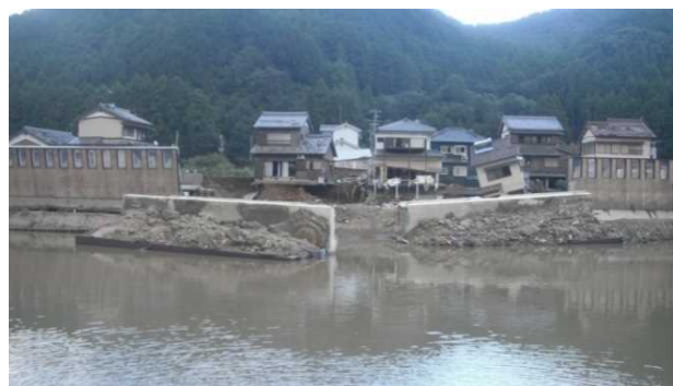
紀宝町（高岡地区）輪中堤の被災状況
