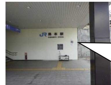
浸水深2.2mJR島本駅東口
