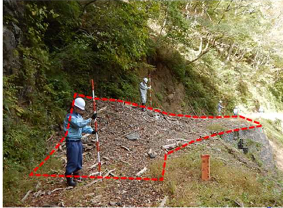
第7号 土砂流出・路肩崩落
