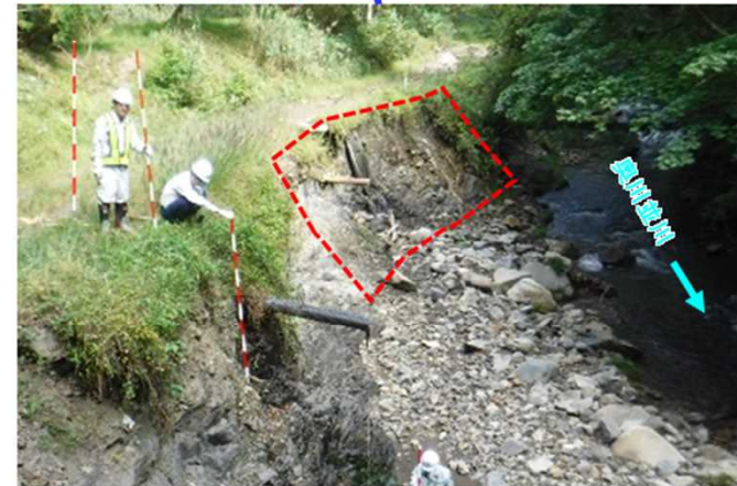
第12号 路肩崩落
