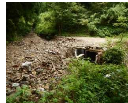
③路肩侵食 (2.78k)
