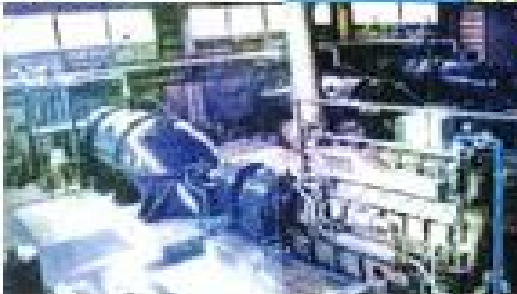
排水機場内部
