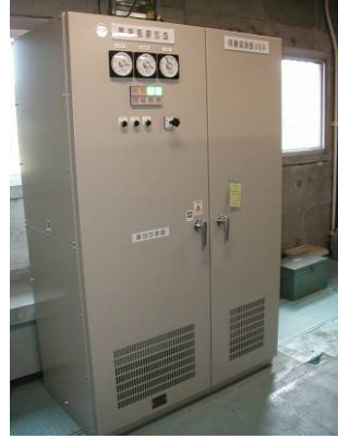
(通信用直流電源設備：施工後)
