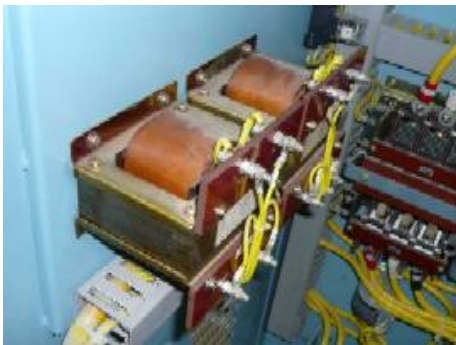
発電機盤(盤内)
