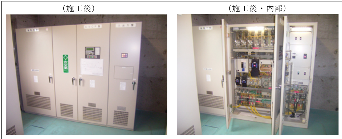
图 1.3.1-6 無停電電源装置整備工事(平成 18 年度)
