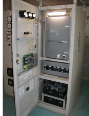
(始動用直流電源設備：施工後)
