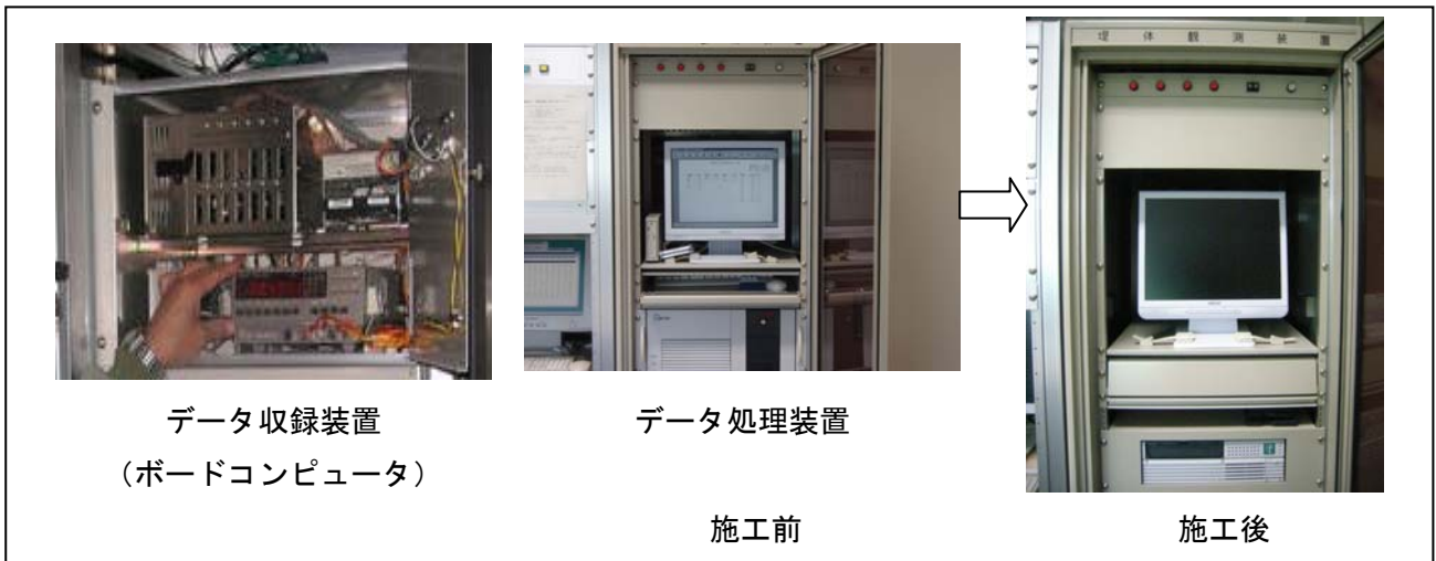
図 1.3.1-21 堤体観測設備整備 (平成 20 年度)
