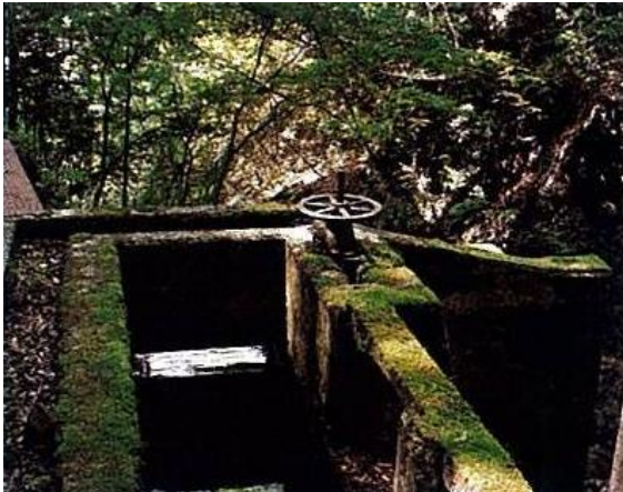
大江谷取水堰堤
