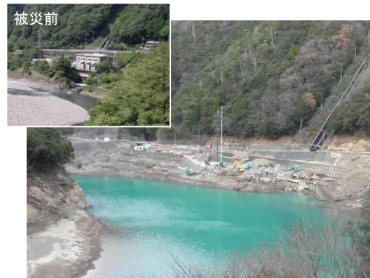
長殿発電所被災箇所
