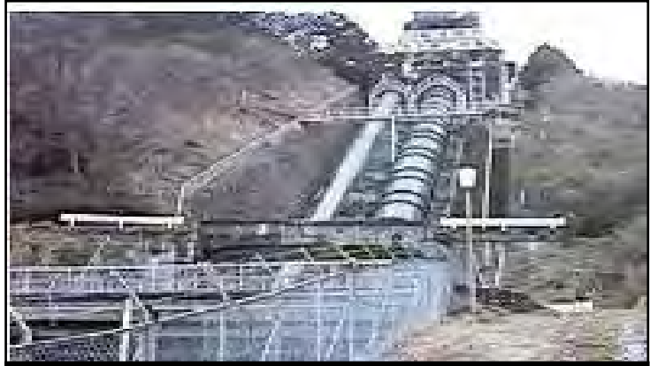
西吉野第二発電所
