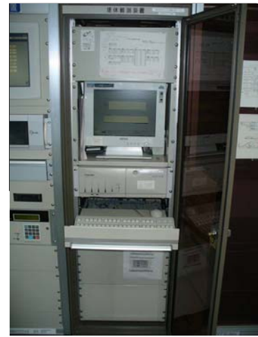
堤体観測装置全景
