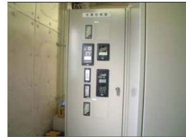
受電制御盤全景
