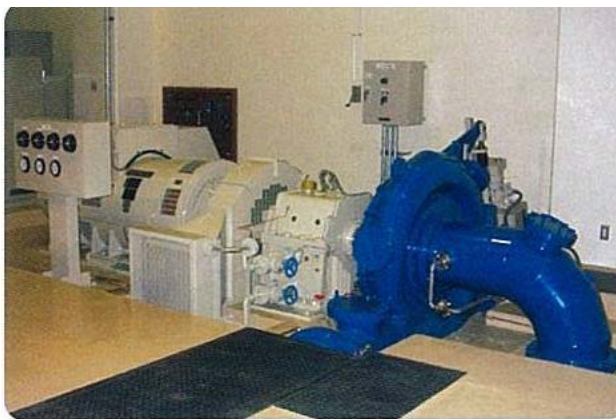
写真 3.3-1 ダム管理用発電施設
