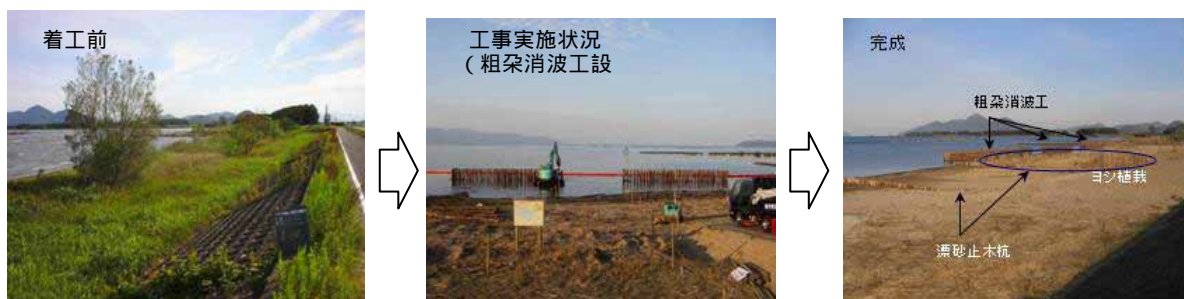
粗朶消波工とヨシの植栽により地盤の安定化を行う (2007年12月時点)
