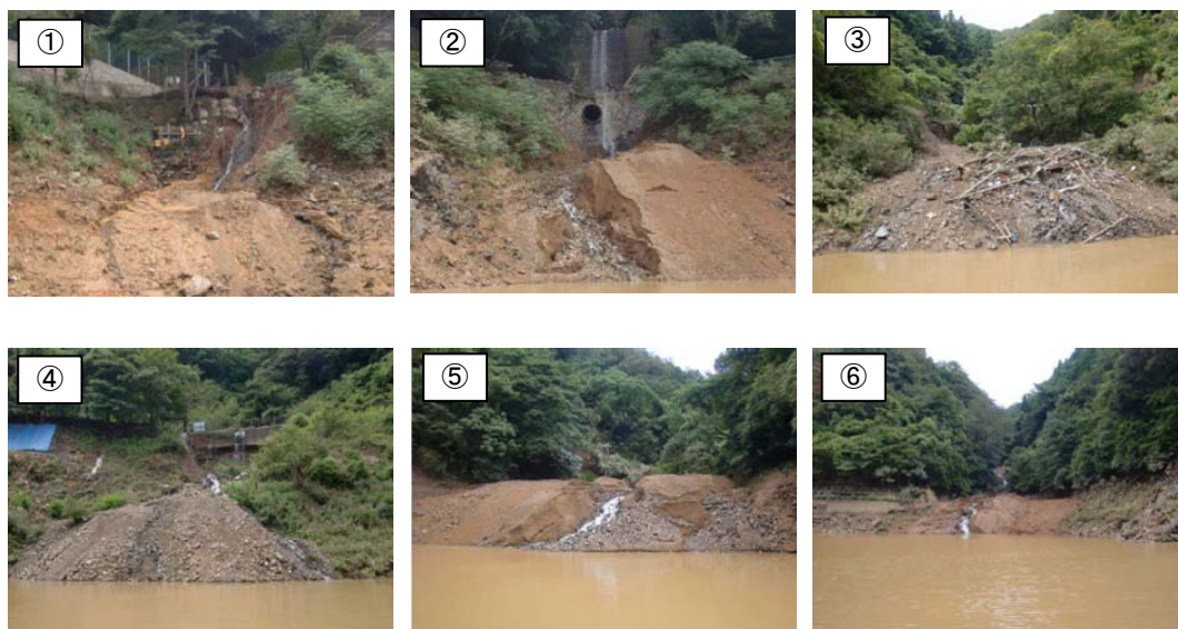
図 4.3-3 土砂流失、湖岸法面の侵食・崩落の状況（平成 24 年度）
