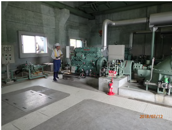
針江排水機場内
