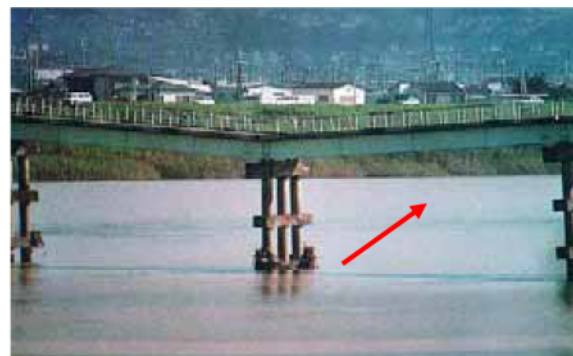
図 1.1.3-5 川底がえぐり取られて 陥没した南海橋 (平成 2 年台風 19 号)
