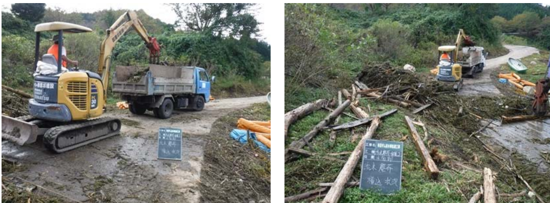
図 2.4.4-3 流木塵芥等揚陸状況
