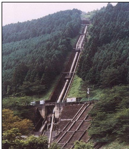
西吉野第一発電所
