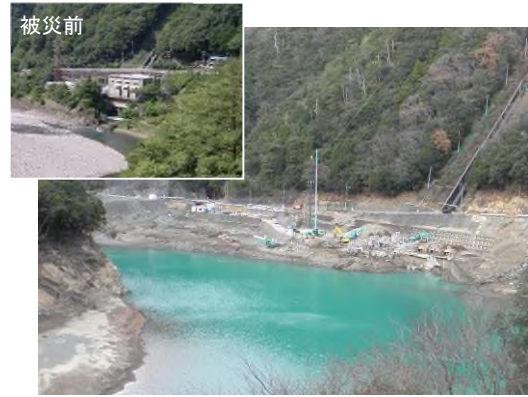
長殿発電所被災箇所
