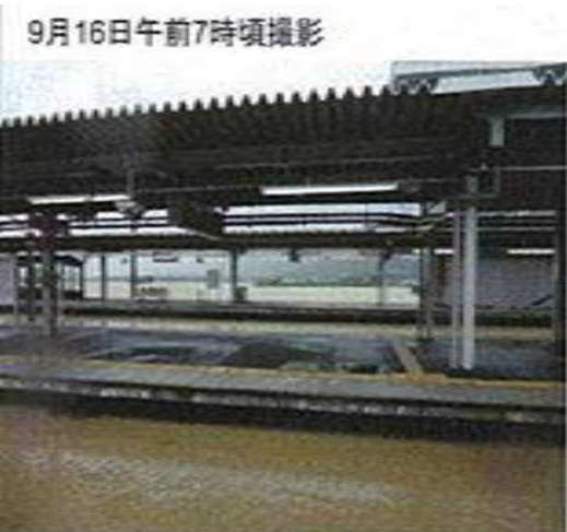
JR亀岡駅の浸水状況
