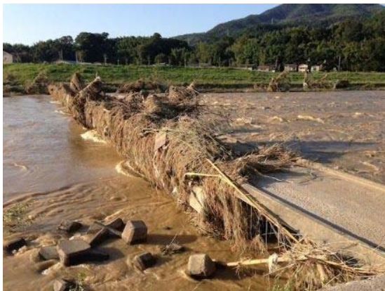
落橋寸前の保津小橋（亀岡市保津橋下流）
