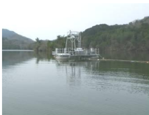
図 5.6.3-3 浅層曝気設備(ダムサイト地点)
