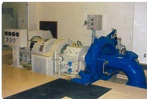
写真 3.4-1 ダム管理用発電施設
