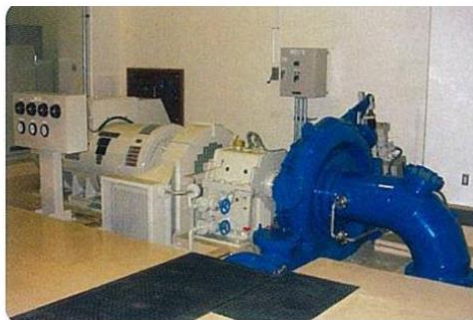
写真 3.4-1 ダム管理用発電施設
